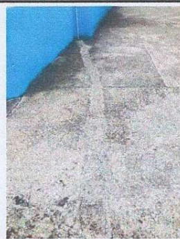
Foto2: Sustrucción de losa de patio por daños de quebraduras por losa de patio de 5 cm de espesor
