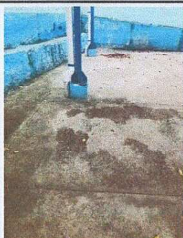
Foto1: Sustrucción de losa de patio por daños de quebraduras por losa de patio de 5 cm de espesor
